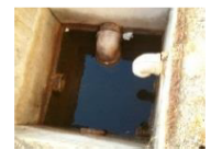
木更津駐屯地の油水分離槽
